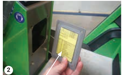
Opis bezpieczników — na odwrocie pokrywy bezpieczników
